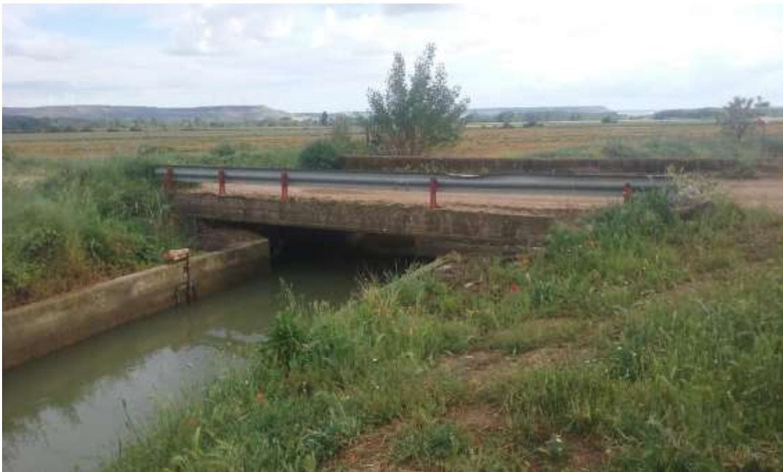
Paso de maquinaria agrícola también hábil para comunicar ambos lados del canal.
