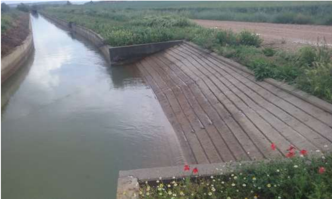
Salidero, sin comunicación en el lado opuesto.
