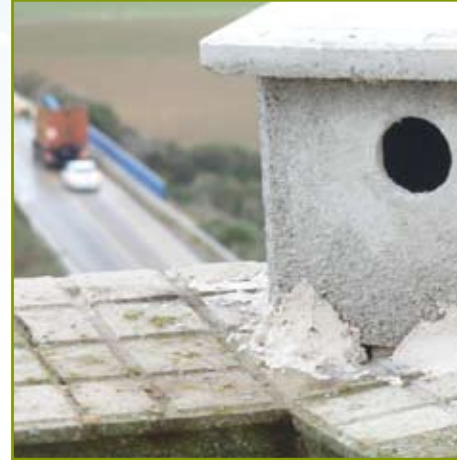
Detalle de un nido instalado en el Silo de San Esteban.
