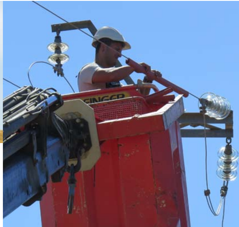
Un operario aísla un tendido peligroso. Evitar las electrocuciones de aves es una de las prioridades del proyecto LIFE Bonelli.
