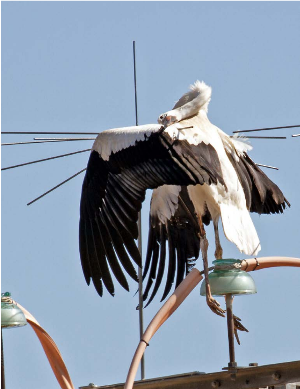
Cigüeña blanca electrocutada debido a la instalación de elementos antiposada y a un aislamiento deficiente
