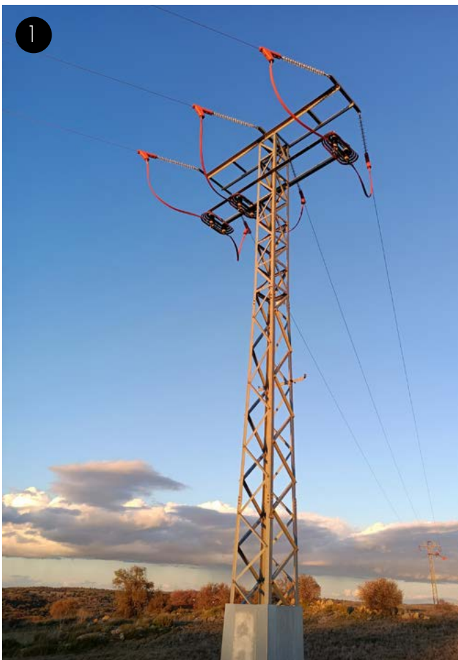
FOTO 1: Tendido adecuado correctamente para evitar electrocuciones. Foto Juan José Iglesias/GREFA.
