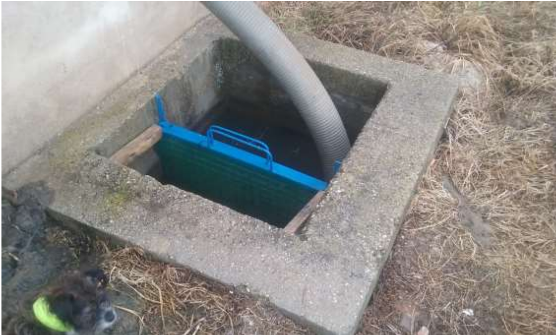
Sifón de paredes verticales sin medidas anticaída de fauna.
