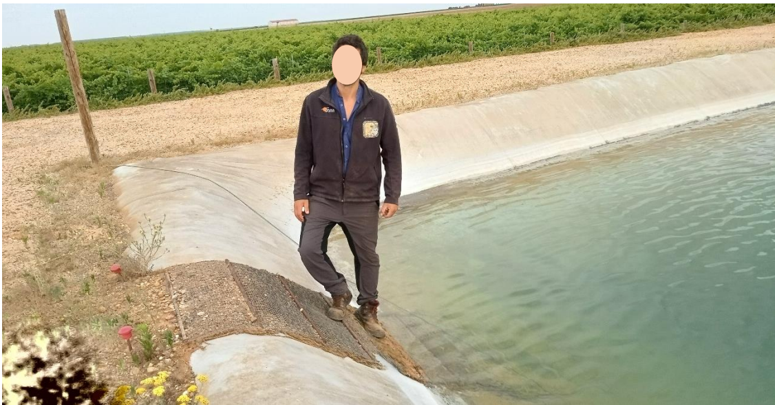
Comprobación de la resistencia de una de las rampas instaladas por GREFA en una balsa de geomembrana 5 años después de su instalación.
