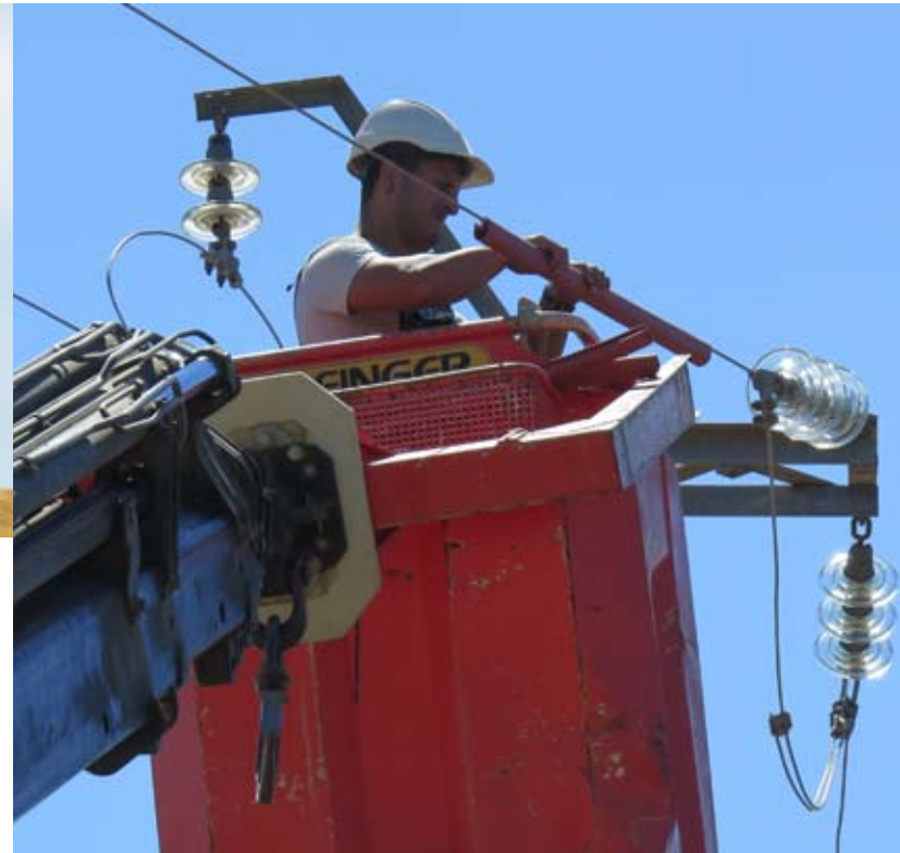
Un operario aísla un tendido peligroso. Evitar las electrocuciones de aves es una de las prioridades del proyecto LIFE Bonelli.
