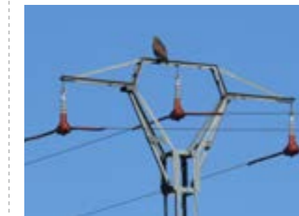
Apoyo de un tendido corregido por AQUILA a-LIFE, con un ratonero posado.
