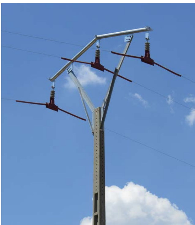
Apoyo eléctrico corregido para evitar electrocuciones de aves en el contexto de AQUILA a-LIFE.
