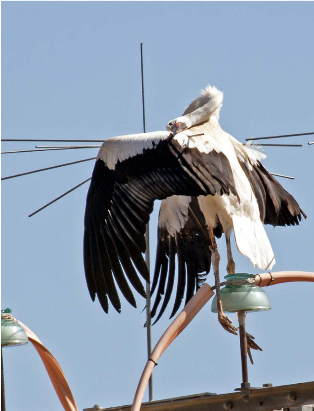
Cigüeña blanca electrocutada debido a la instalación de elementos antiposada y a un aislamiento deficiente
