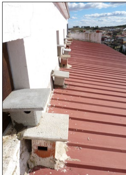
Cajas nido para cernícalo primilla en el silo de La Almarcha (Cuenca).
